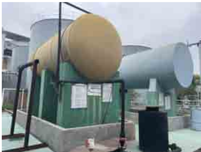
酸碱储罐区(依托现有)
