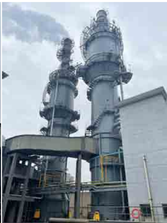
石灰石-石膏脱硫塔(依托现有)
