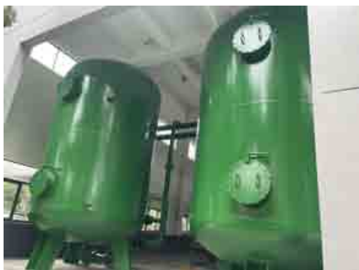
化水系统(新增活性炭罐等)
