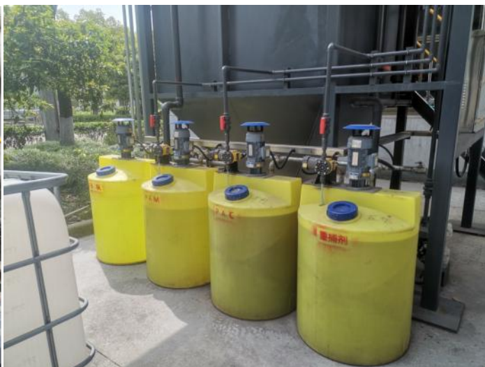
脱硫废水处理设施(新增)
