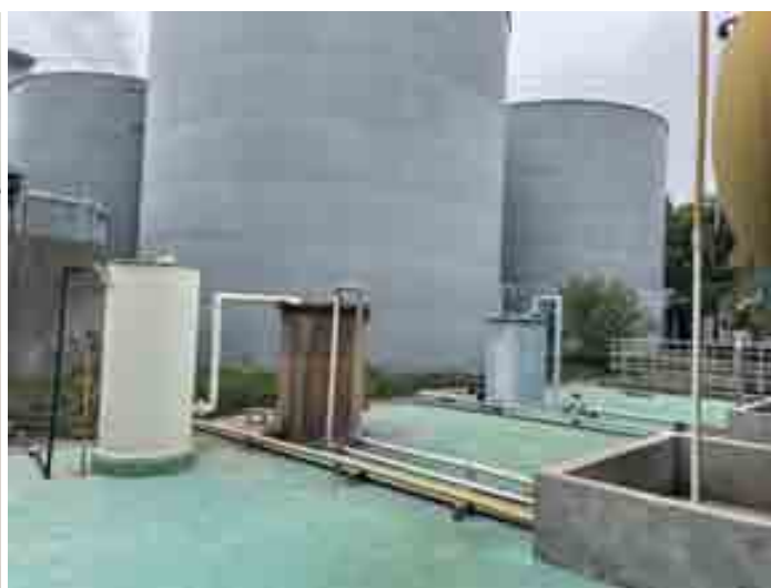
储罐呼吸气治理(现有)
