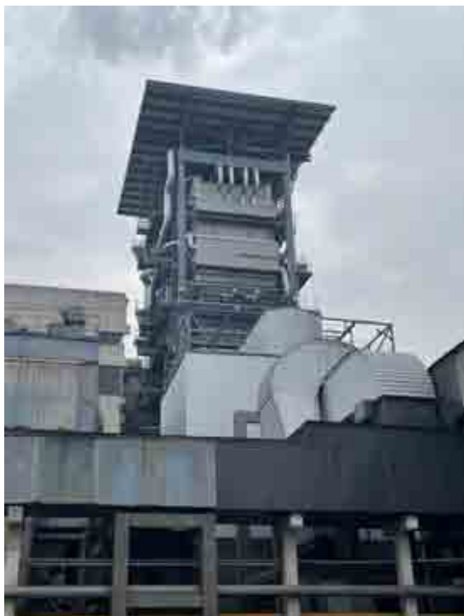
新上的 70t/h 循环流化床锅炉
