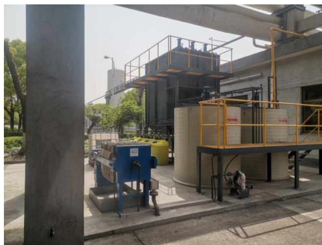
脱硫废水处理设施(新增)
