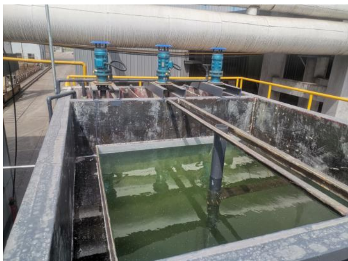
脱硫废水处理设施(新增)
