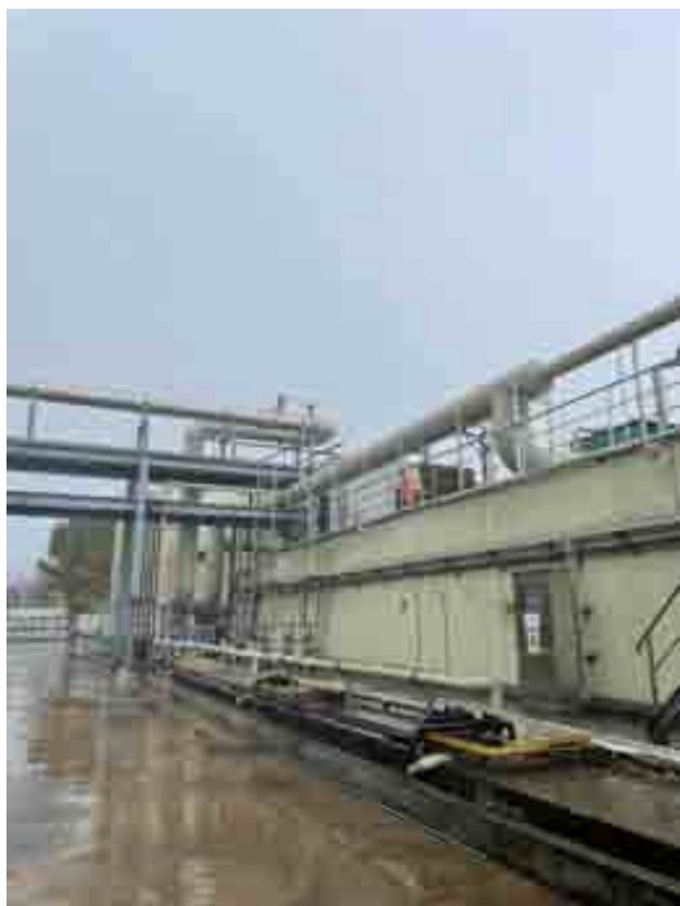
废气收集风管
