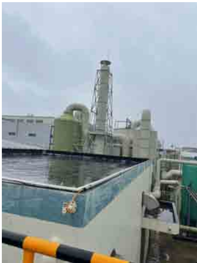
污水处理站废气处理设施
