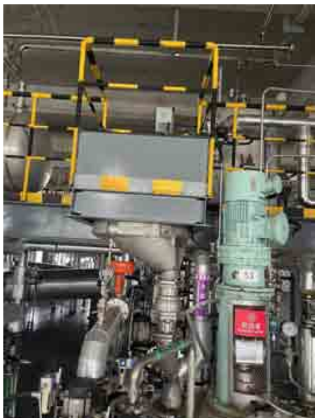
3 车间块状蜡投料口
