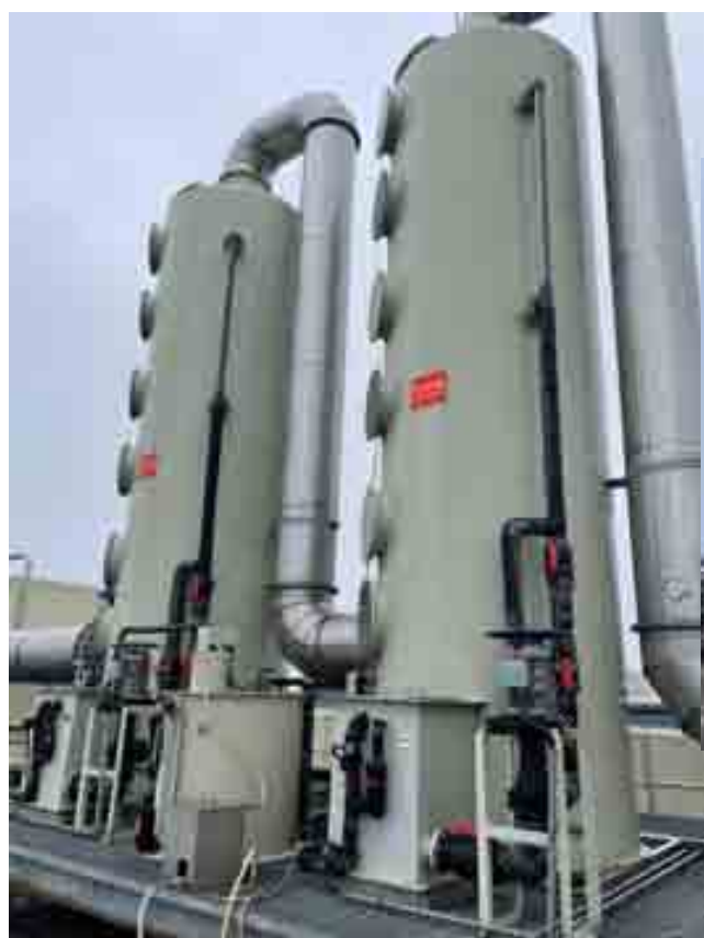
2 车间废气处理设施
