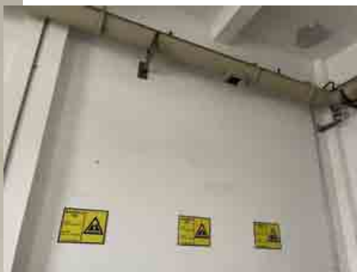
危废仓库废气收集管网
