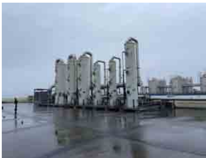
4 车间废气处理设施
