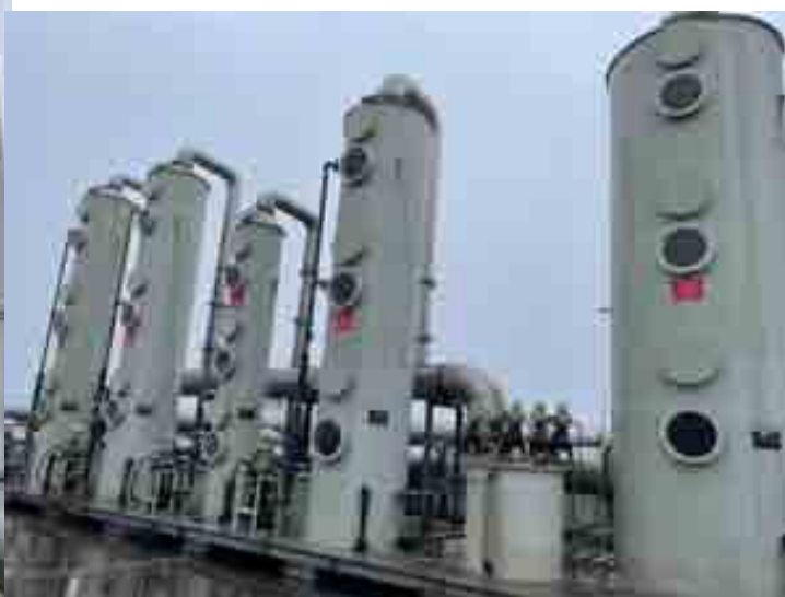
3 车间废气处理设施
