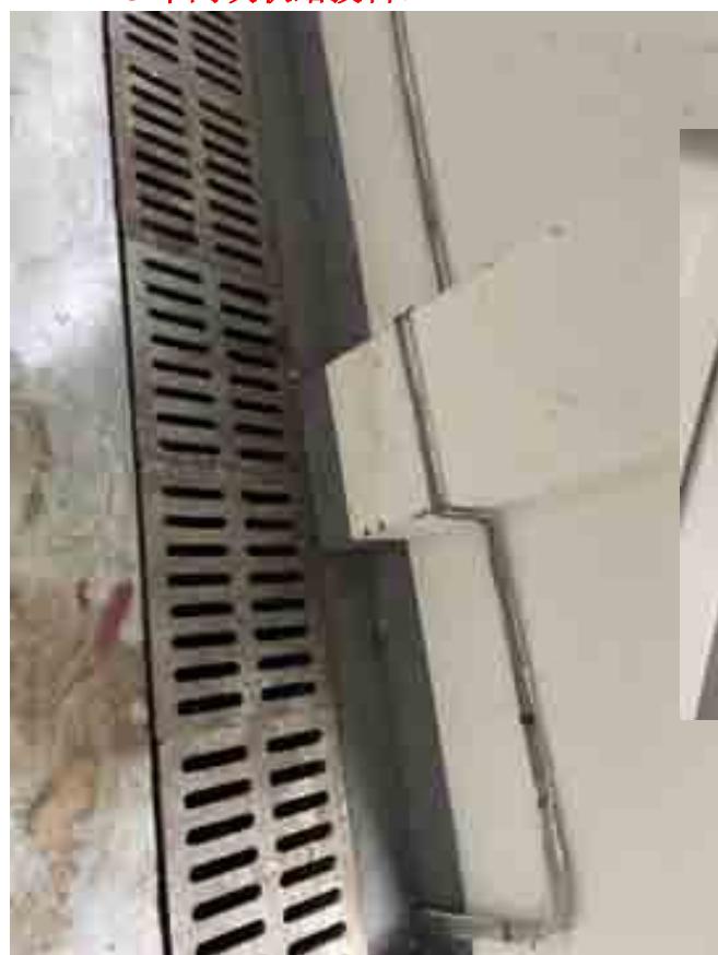
危废仓库内部截水沟
