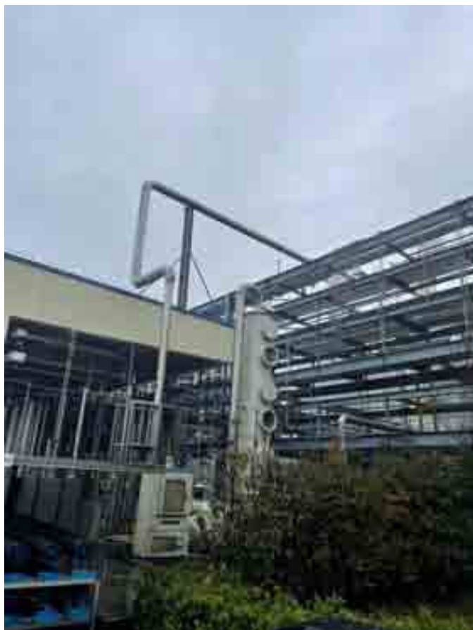
储罐区废气喷淋预处理
