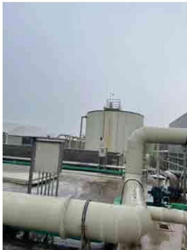
污水处理站废气收集风管
