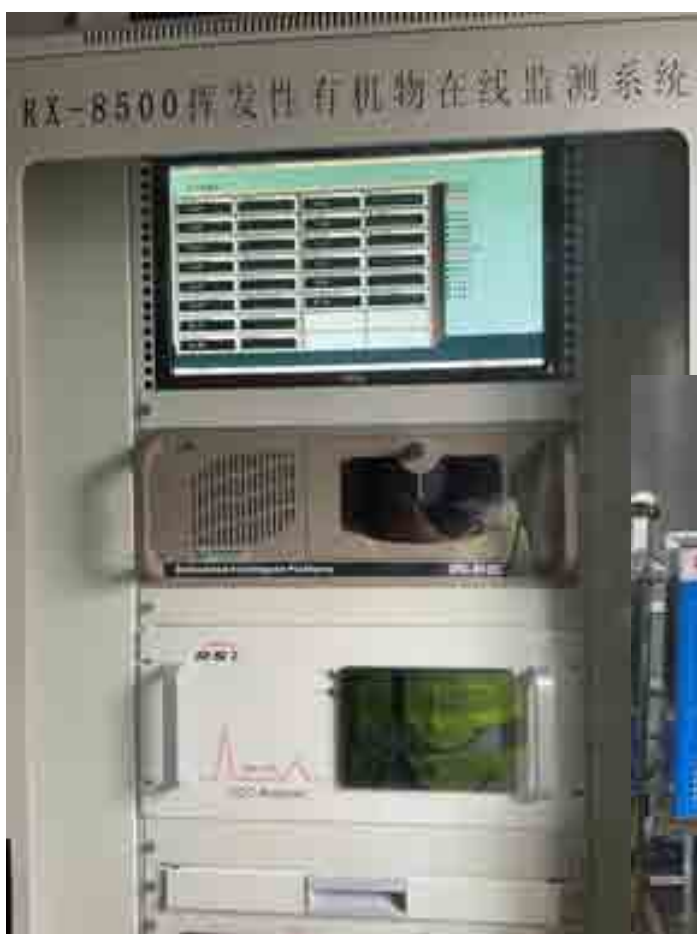
RTO VOCs 在线装置
