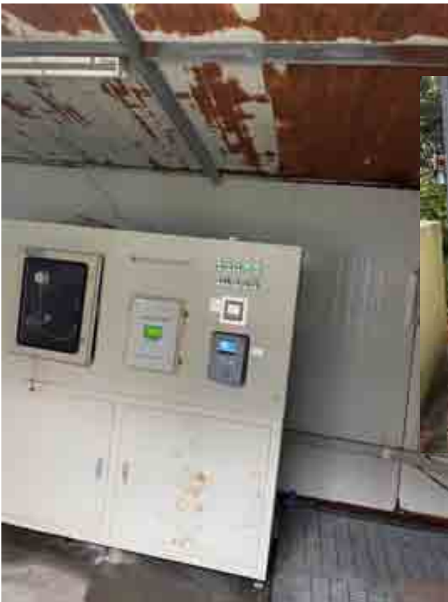
雨水排放口在线设施
