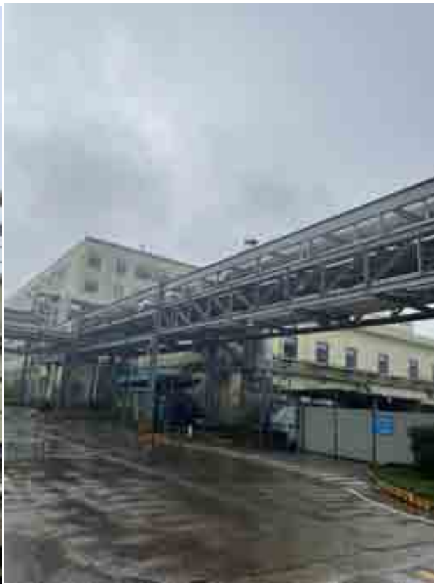
废气收集风管
