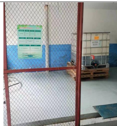
危废仓库内堆放的废染料助剂包装袋
